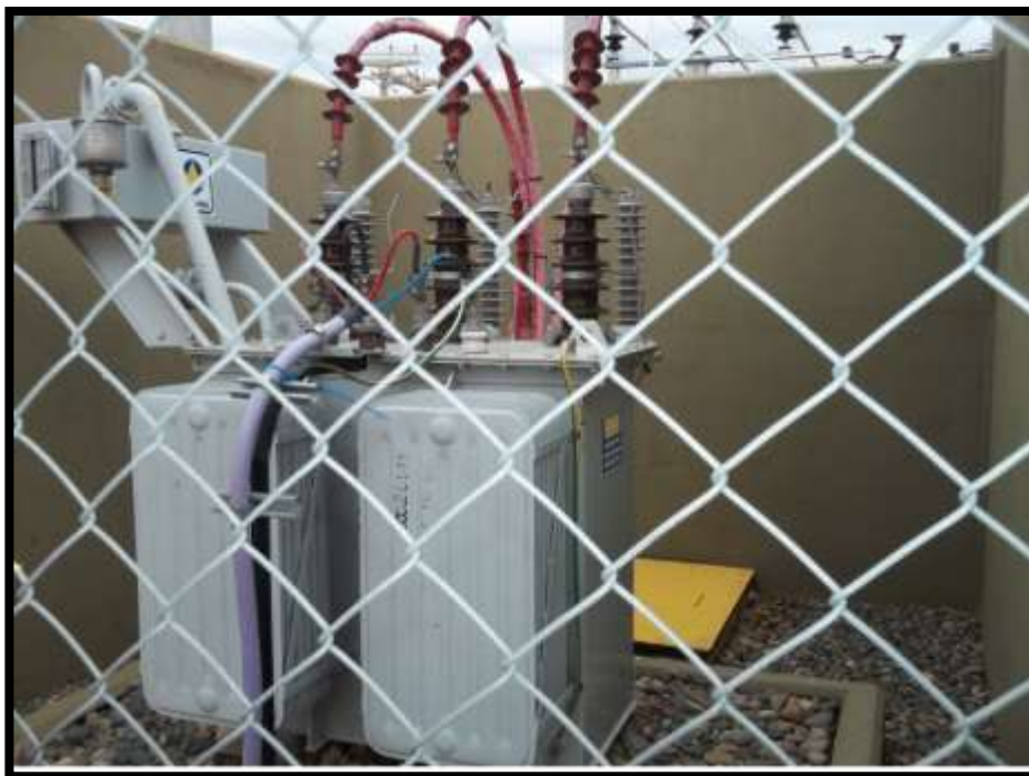
FIG. I-6 - Transformador auxiliar de Central Térmica Plaza Huincul.
