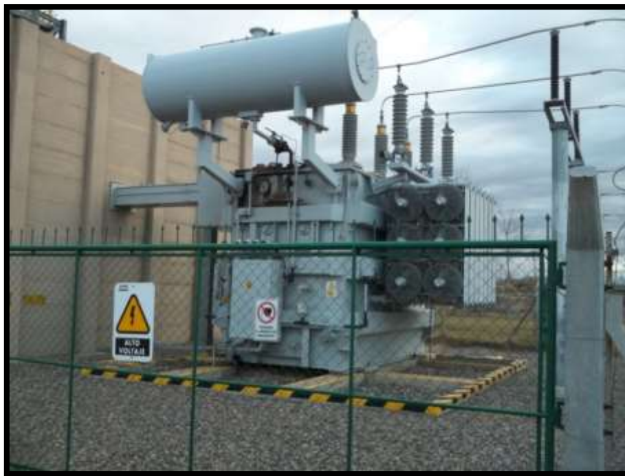
FIG. I-5 - Transformador de Central Térmica Plaza Huincul.
