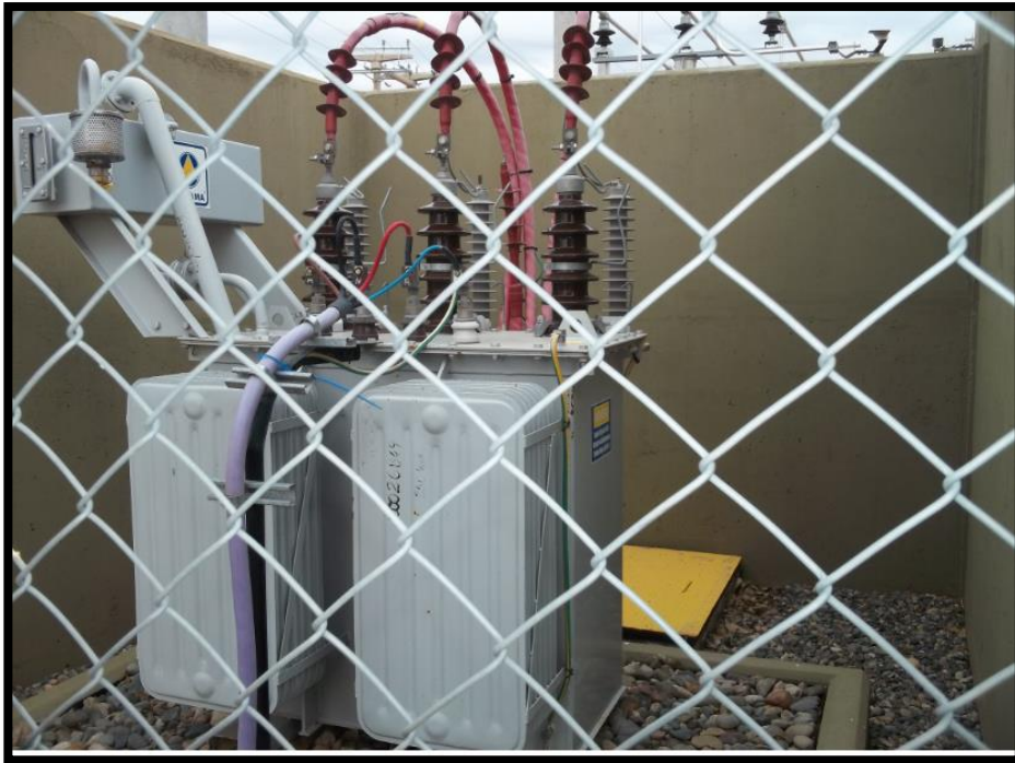
FIG. 7 - Transformador auxiliar de Central Térmica Plaza Huincul.
