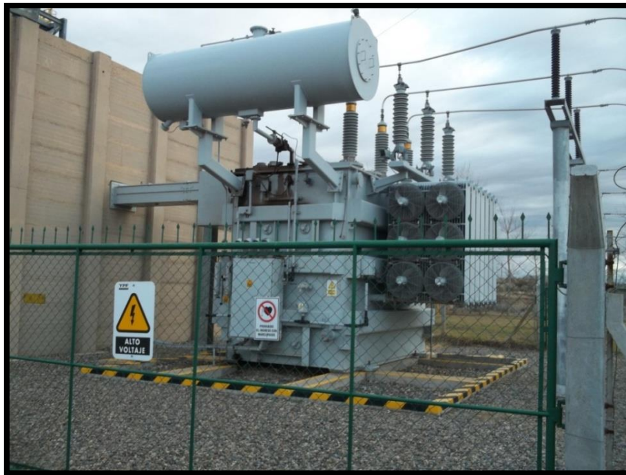
FIG. 6- Transformador de Central Térmica Plaza Huincul.
